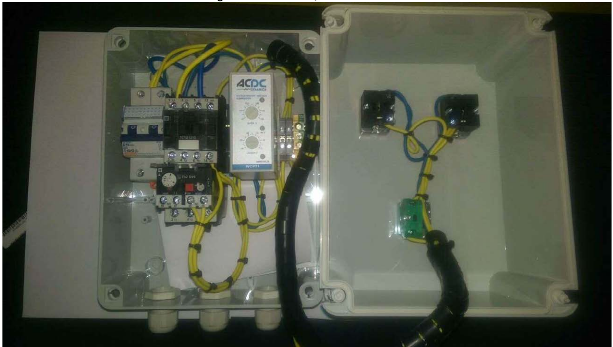
Imagem 2- Interior do Quadro comando
