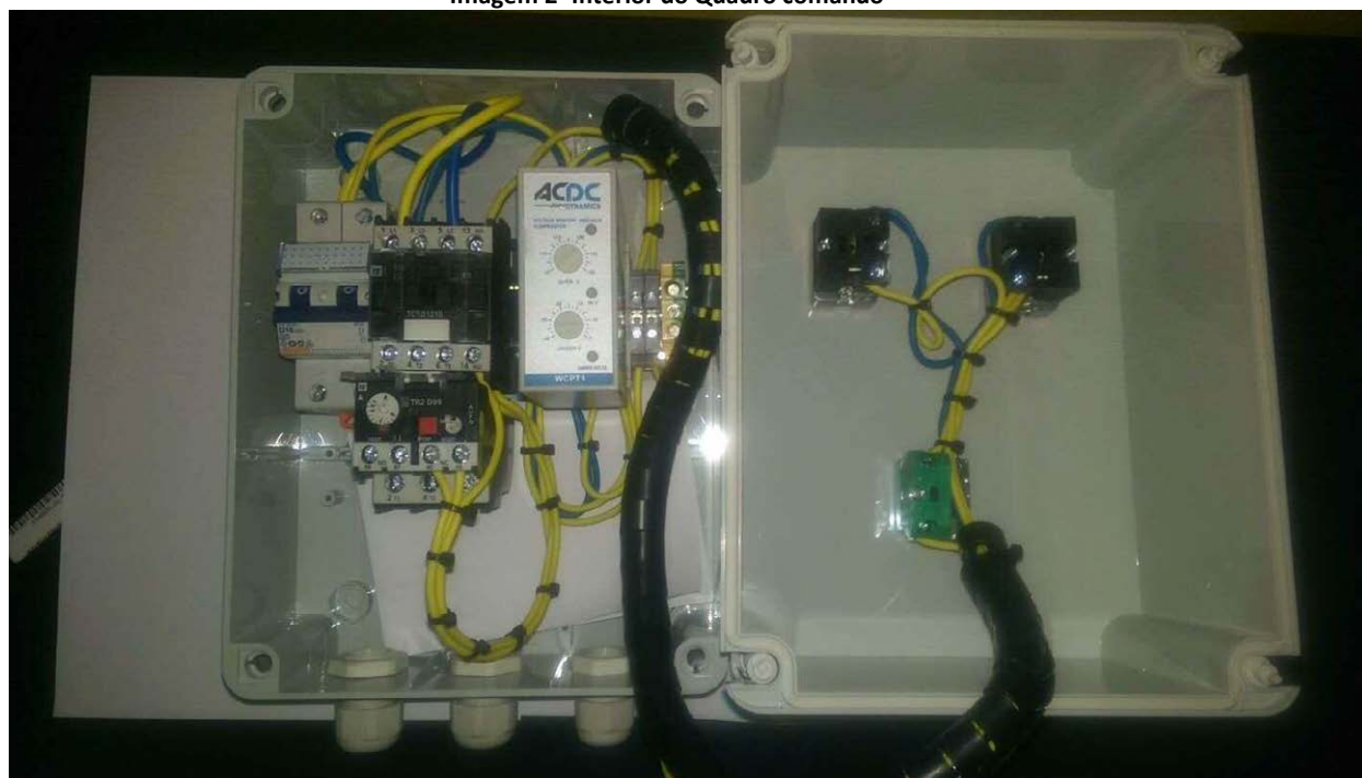
Imagem 2- Interior do Quadro comando
