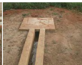
排水溝・浸透樹
