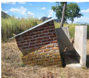
トイレピットが崩落しトイレ 建屋が傾いている
