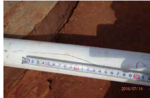
亀裂が確認された揚水管の状況。
