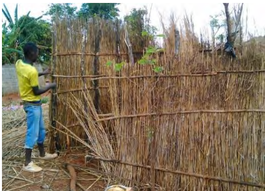
野外排泄撲滅に向けてトイレ建設をしている様子 (事前訪問時)
