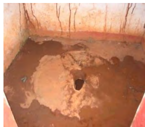
スラブ周辺部が液体で濡れて 不衛生な状況となっている
