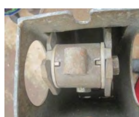
ポンプ内部の確認
