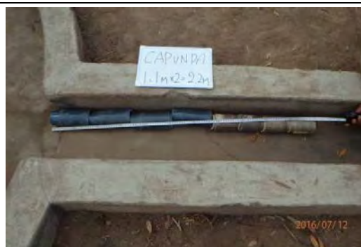
井戸から抜き出すために切断した PVC 揚水管。
