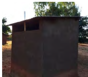
構造が不適切な通気改良型 ピット式トイレ
