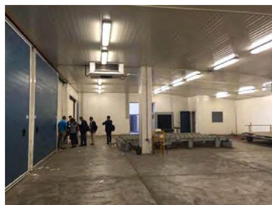
キガリ国際空港の冷蔵設備
