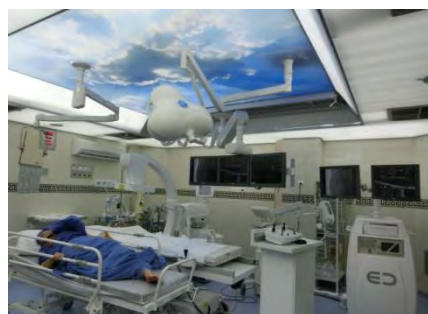
□血管X線撮影装置、シングルプレーン イタリア製。病院から所属の神経内科認定医と循環器内科医が場所を借りて使用している。脳血管内治療にはバイプレーンが適しているが、現在はシングルプレーンで実施している。
