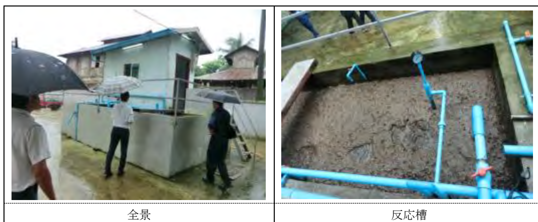
写真 1-3 YCDC の職員宿舎に設置された膜分離活性汚泥法 (MBR) 施設の様子
