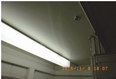
写真7-1-3 小屋の天井に漏水の跡写
