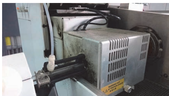
写真7-2-10 すすの粉で黒くなった高圧部
