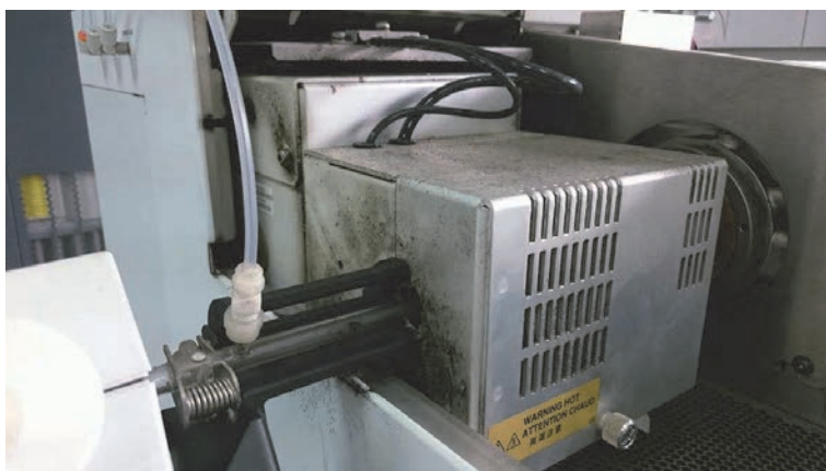
写真：すすの粉で黒くなった高圧部
