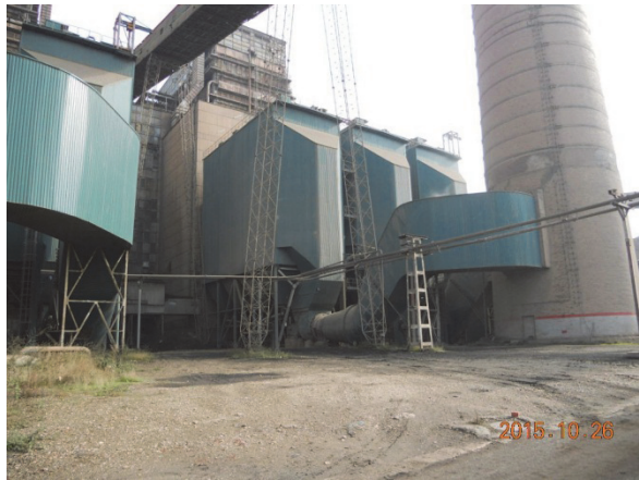
写真 8-1-6b 各ボイラには 3 基の ESP が 設置されている (A-3 号機)
