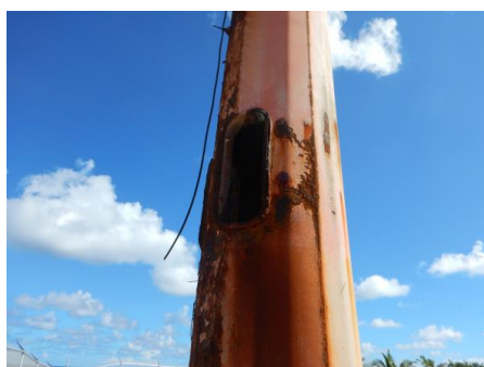
写真 3-5 アンテナタワー自体の腐食
