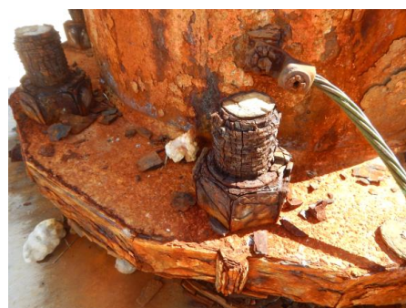
写真 3-6 アンテナタワー土台部分の腐食
