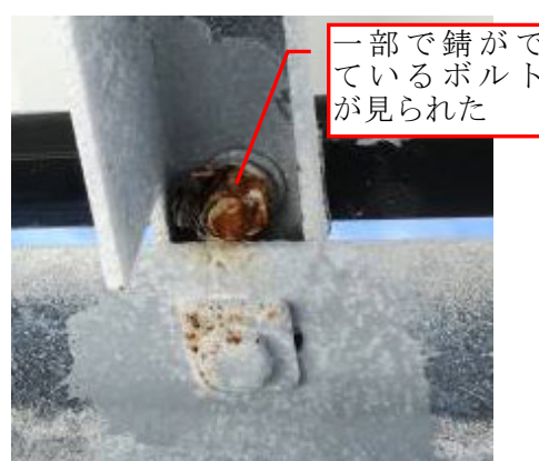
写真 3-2 架台ボルト部分
