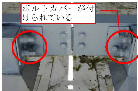
写真 3-3 架台部分ボルトへのカバー
