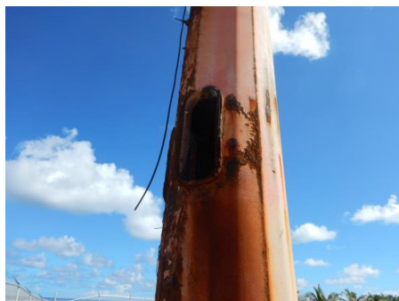
写真 3-5 アンテナタワー自体の腐食
