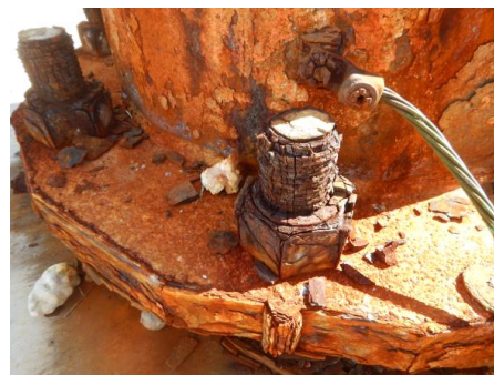
写真 3-6 アンテナタワー土台部分の腐食
