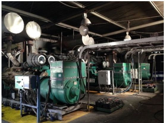
4: KAJUR が運用中のディーゼル発電機 定格出力 1,200kW 3 台を手動操作により起 動・停止をしている
