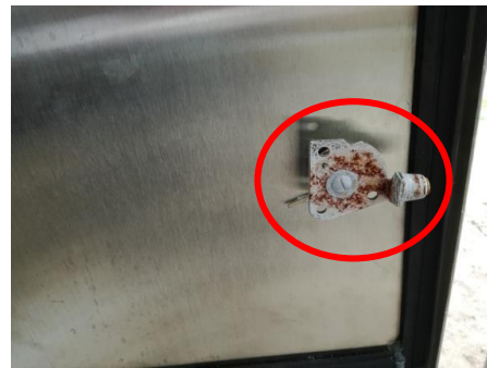
写真 3-10 異種金属接触腐食の様子
