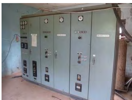
排水機場・コントロールハウス内
