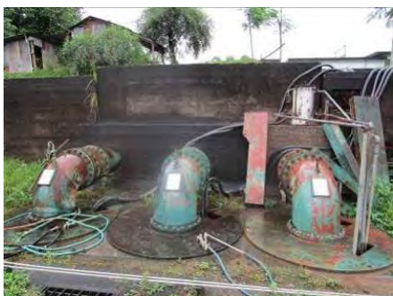
揚水機場・ポンプ全景
