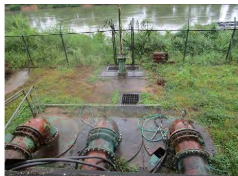
揚水機場・取水口ゲートとナム・ Gum 川
