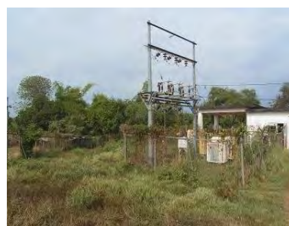
揚水機場・受電設備
