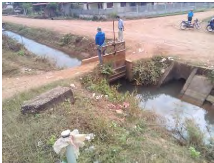
調整ゲート（No.6 分水工地点）
