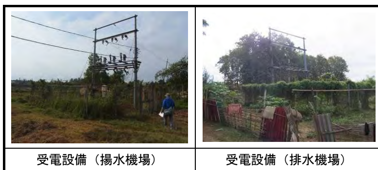
写真 2-5 : 受電設備状況
