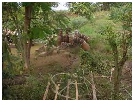
排水機場・ポンプ全景
