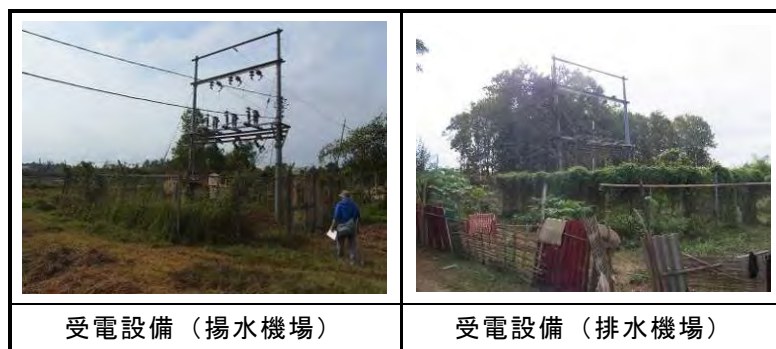
写真 2-5：受電設備状況
