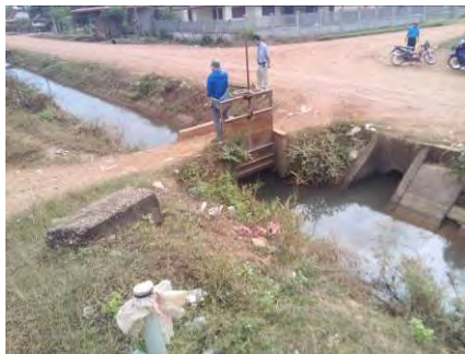
調整ゲート（No.6 分水工地点）
