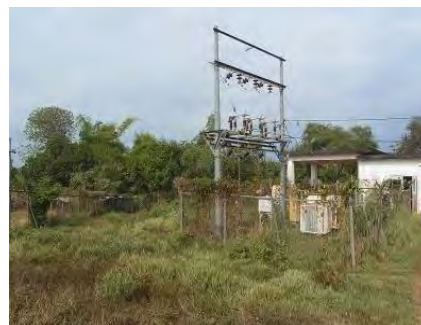
揚水機場・受電設備
