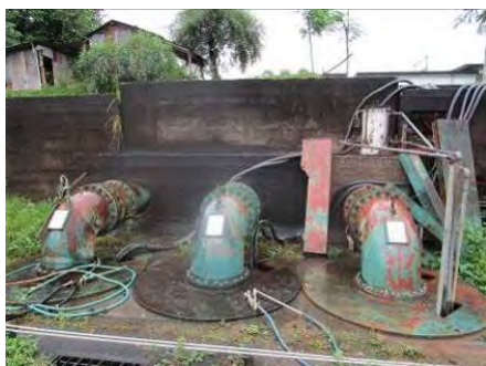
揚水機場・ポンプ全景
