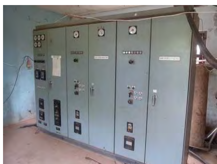
排水機場・コントロールハウス内
