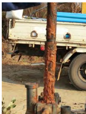
腐食した鋼製揚水管 (India Mark II 型ハンドポンプ)
