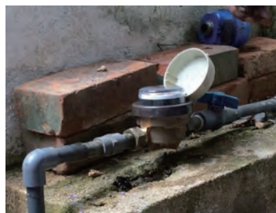
写真 10: 隙間のある設置例
