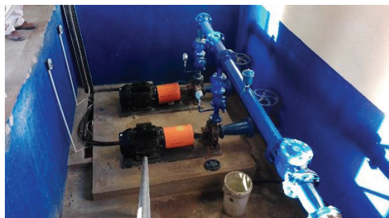
写真 3-④-a LUMBADZI BOOSTER (ブースターポンプ)
