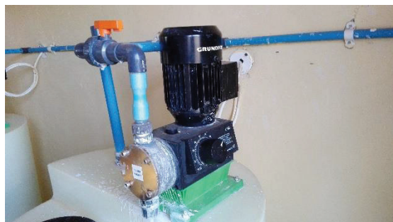
写真 3-④-b LUMBADZI BOOSTER (塩素注入ポンプ)
