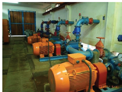
写真 3-③ MWENDA BOOSTER (ブースターポンプ)
