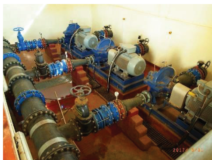
写真 3-①-a MTUNTHAAMA BOOSTER (ブースターポンプ)
