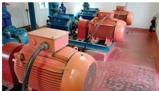
写真 3-①-b MTUNTHAAMA BOOSTER (ブースターポンプ)
