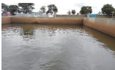
原水井（通常時）
