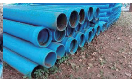
保管されている PVC 管 （LWB 本部） 屋根付き資材置き場を建設中。
