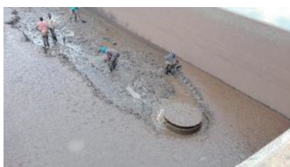
原水井（清掃時） 底に土砂が 60cm 溜まっている。
