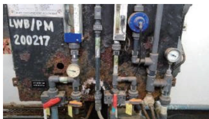
1980 年代の設置 TW 次亜塩素酸生成装置 (1984)
