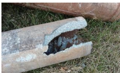
交換された石綿管 ヒビが入りやすく、衝撃に弱い。穿孔時に破損することもある。
