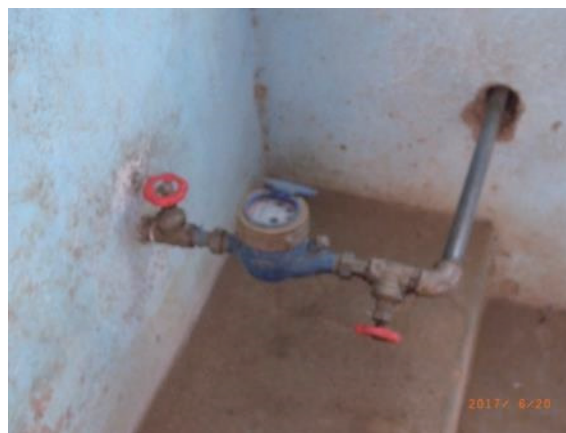
写真-3.1-9 Kiosk②のメーター (左写真の小屋内に設置)
