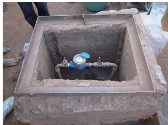
写真-3.1-7 Kiosk①のメーター (左の写真の右手に設置されている)
