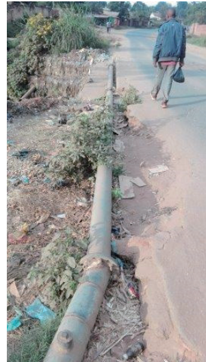
リロングウェ市内では露出した配管がみられる。
