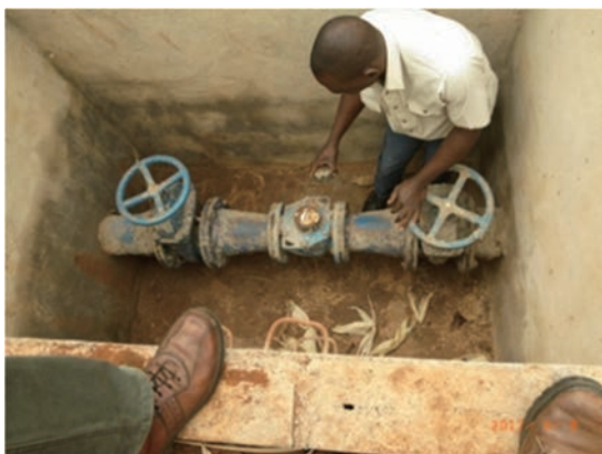
写真-3.12-6 エリア 15 流量計室 (覆蓋が無い)
