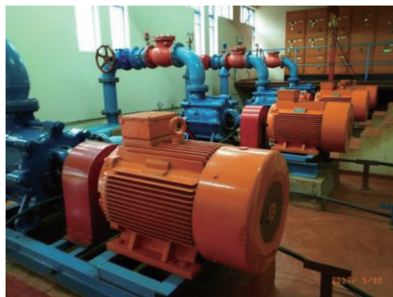
写真-3.10-2 TW I のポンプ設備
