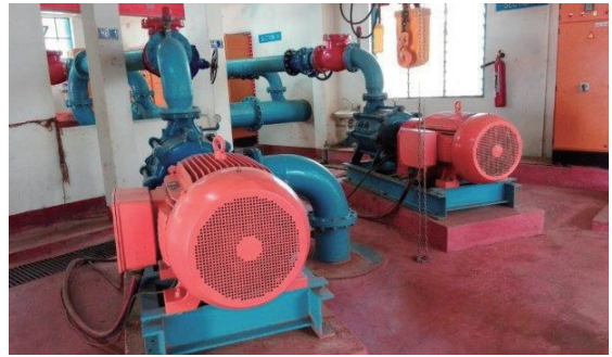
TWI 送水ポンプ
