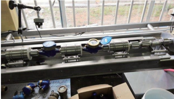
TW II 構内に設置されたメーター・テストベンチ。
