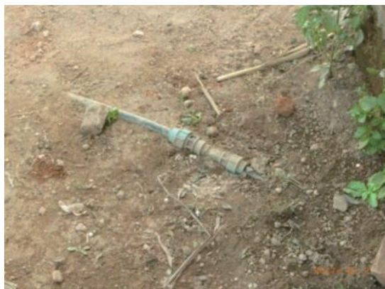
写真-3.12-11 露出している給水管
