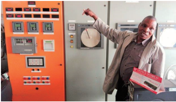
浄水場制御盤
