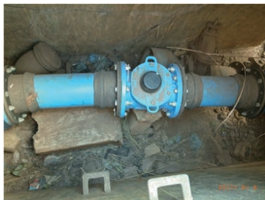
写真-3.12-7 エリア 7 流量計室 (A 道路側)
