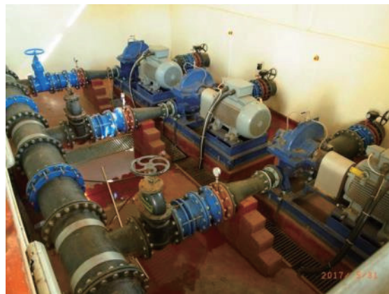
写真-3.1-4 ブースターポンプ所
