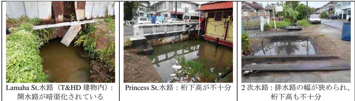
写真 R 2.1.1 人為的な排水路の閉塞・狭小化
