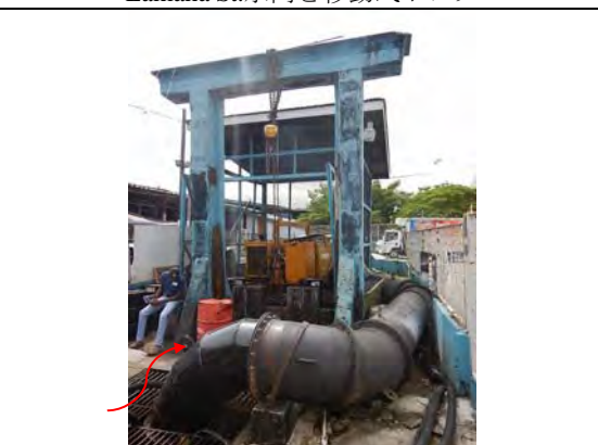
Commerce St 水門と移動式ポンプ
