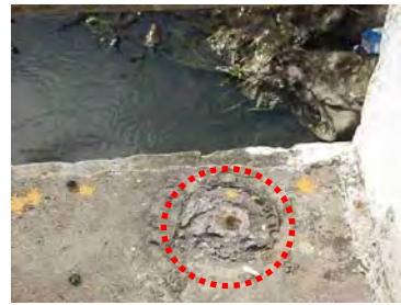
GT20 (Church St.水路の橋梁。鋼棒が紛失し現在未使用。)
