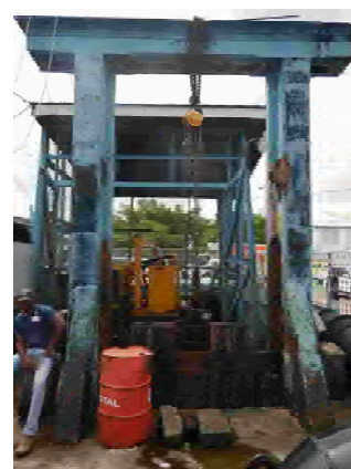
チェーンブロック式 (Commerce St.水門)
