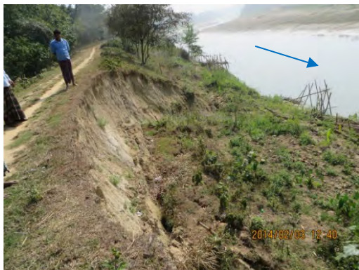
Manu 川 Moulvibazar 地先の堤防侵食
