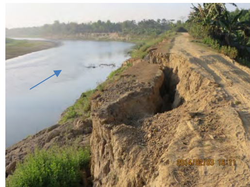
Manu 川 Moulvibazar 地先の堤防侵食
