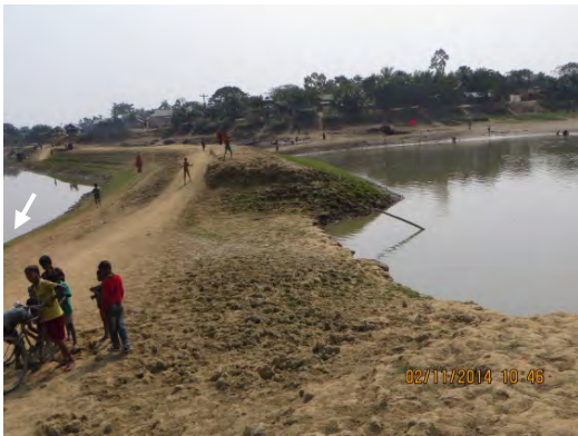
Netrokona 地先の被災堤防（潜水堤防）
