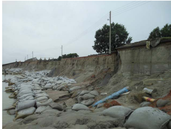
写真 1：堤防崩壊現場（Sirajganj）
