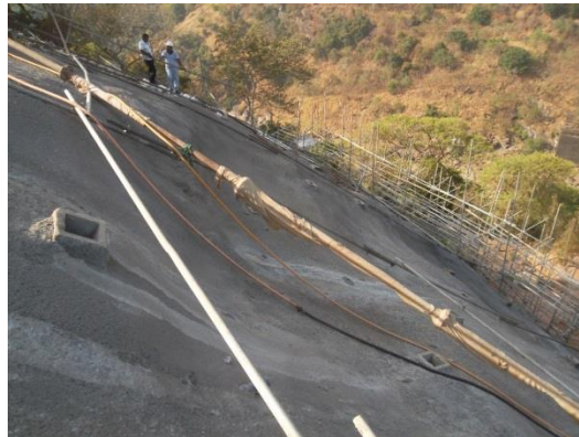
図 3-5：吹付工に設置された植栽ポット（四角形の穴）(Victoria Dam)
