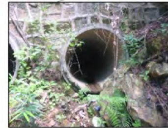
⑨横断管の状況 ジョイントで外れている(起点側)
