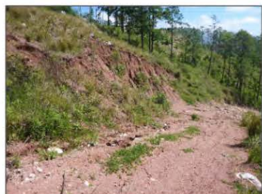
⑨ 地すべり頭部の滑落崖の状況
