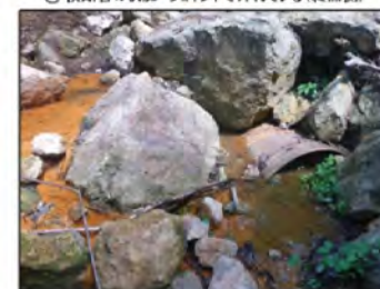
⑪古い横断管 埋没している
