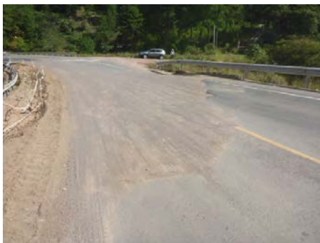
応急後の状況
