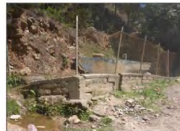
⑥パナマカン エル・セモラノ大学の給水施設 被災している
