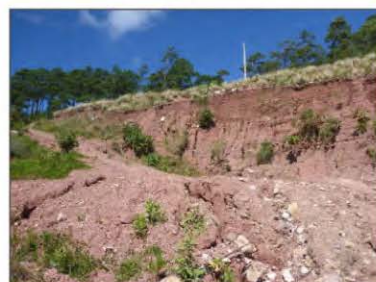
⑦ 地すべり頭部の滑落崖の状況
