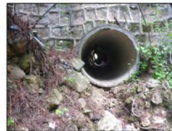
⑧横断管の状況 ジョイントで外れている(終点側)
