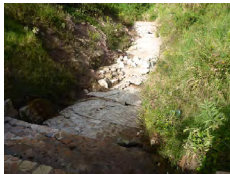
地すべり活動により被災した水路
