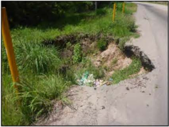
⑥ 横断管上部の陥没
