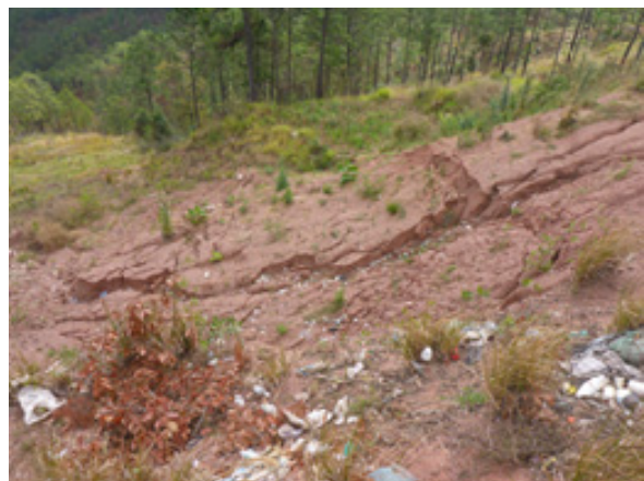
写真-3 Sta.14 地すべり土塊の状況
