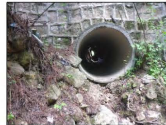
⑧ 横断管の状況 ジョイントで外れている(終点側)
