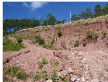
⑦ 地すべり頭部の滑落崖の状況
