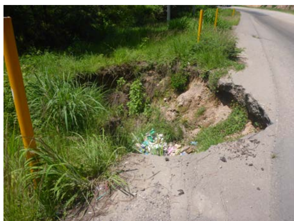
写真-5 Sta.22a の状況 道路が陥没している
