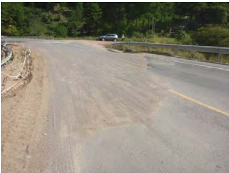
応急後の状況
