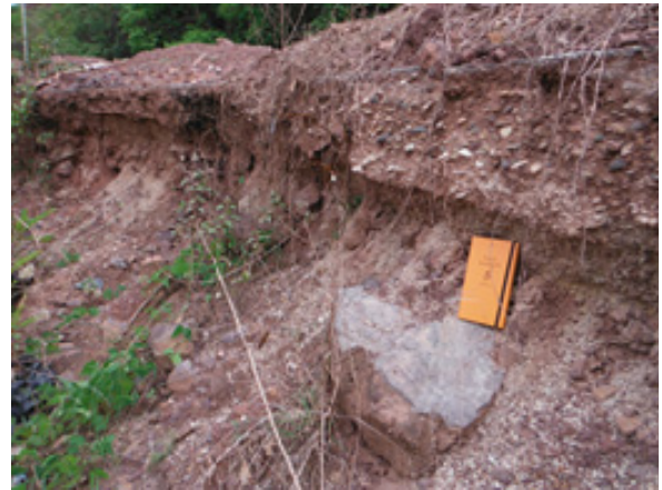
写真-10 Sta.63 の地すべり頭部の状況②
