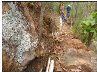
⑧ 斜面中腹の排水管(©アメリカン大学エル・サモラノ大学所有)
