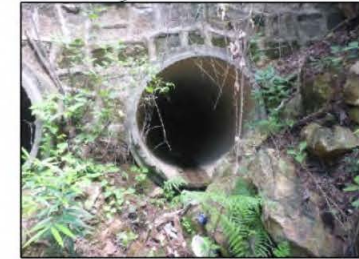
⑨ 横断管の状況 ジョイントで外れている(起点側)
