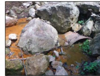
⑪ 古い横断管 埋没している
