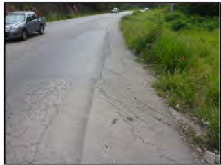
⑦ 路面状況 補修跡が認められる
