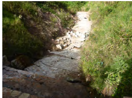
地すべり活動により被災した水路
