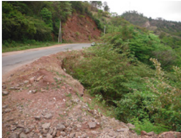
写真-9 Sta.63 の地すべり頭部の状況①
