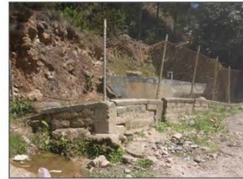
③ パンアメリカン エル・サモラ大学の給水施設 被災している
