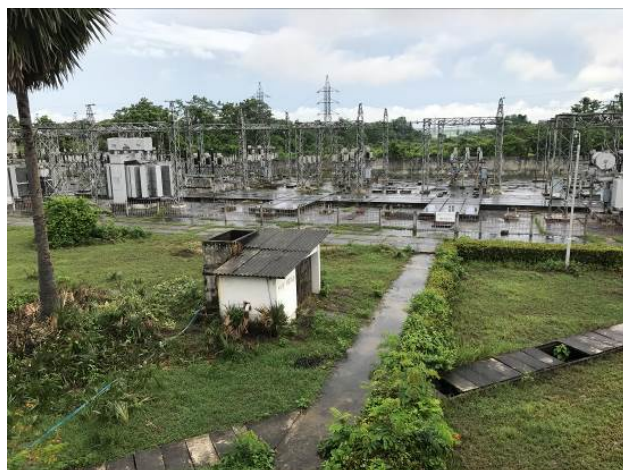
Photo-2 Switchyard 全景
