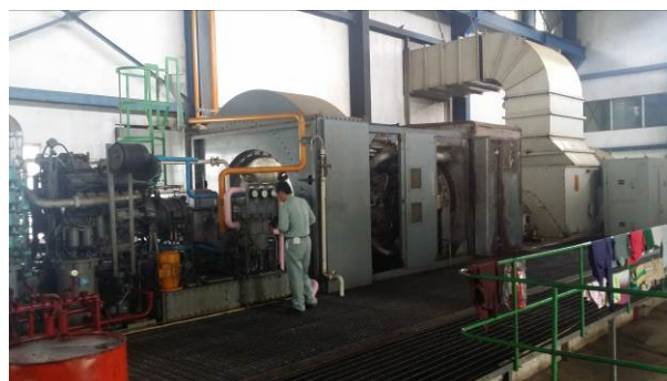
Photo-12 運転中既設ガスタービン (John Brown 製)
