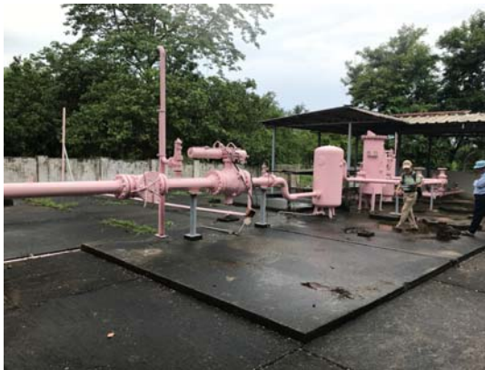
撮影：調査団 写真 Myanaung 発電所ガスヤード
