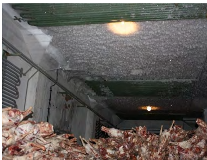
図 3.2.5 冷凍庫の霜（冷凍効率がよくない）
