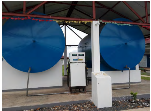
センターの燃料タンク
