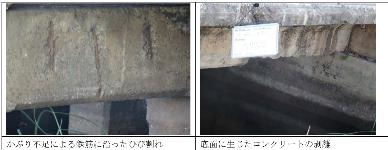
図 II-30 コンクリート桁の損傷
