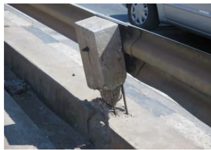
ガードレール支柱破損
