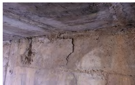
コンクリート剥落、鉄筋露出
