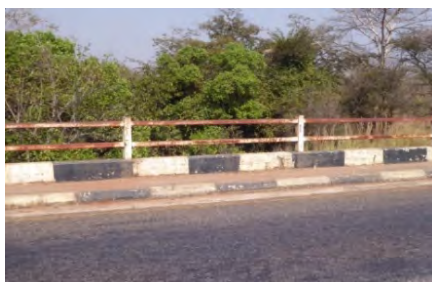
ガードパイプ腐食
