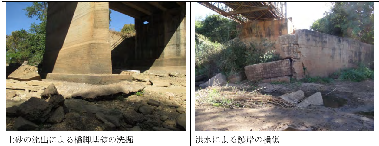
図 II-33 基礎工の損傷
