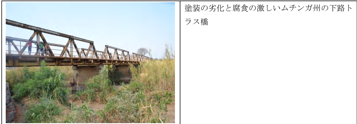
図 II-29 トラス橋の腐食
