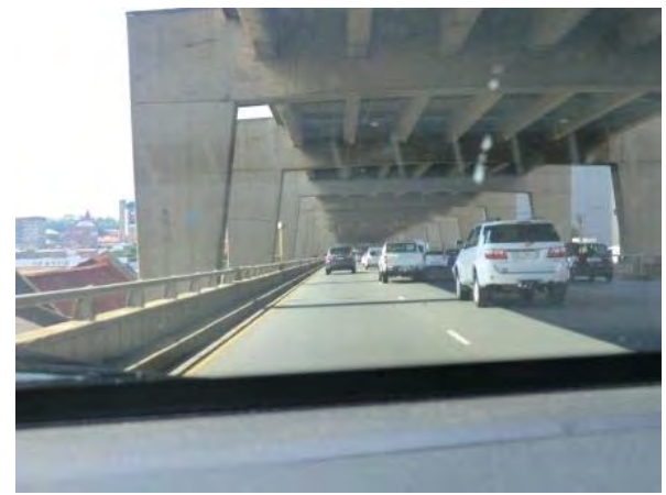
ヨハネスブルグ市内の橋梁の損傷 (クラック、遊離石灰の表出等)
