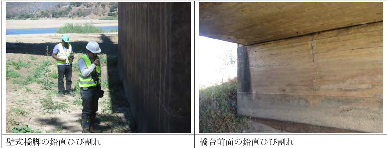
図 II-32 下部工の損傷
