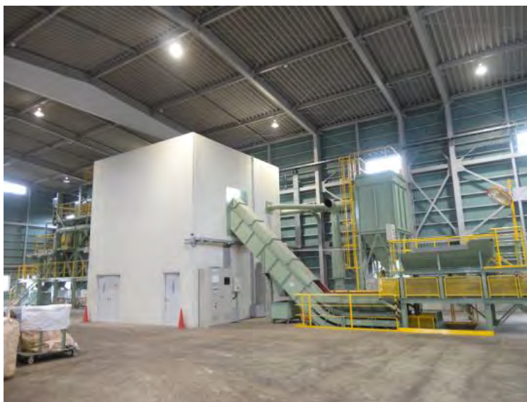
図表 3 NMD の E-waste からの金属回収設備（ひびき工場）
