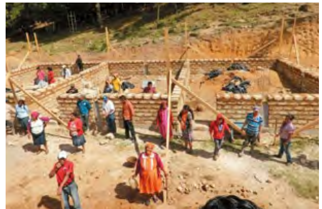
地域資源を利用した校舎増築事業。コミュニティで13グループを作り、各グループが毎日順番に作業する。教育省の規格に合うよう、ホンジュラスの市連合会職員がアドバイスをを行う(ホンジュラス「地方開発のための自治体能力強化プロジェクト」)
