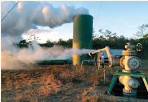
地熱発電所での噴気試験の様子
