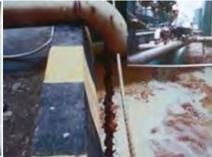
ベダン社での汚水処理後の水が出てくる配管
