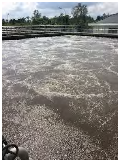
チャノック工業団地共同排水処理場の曝気槽
