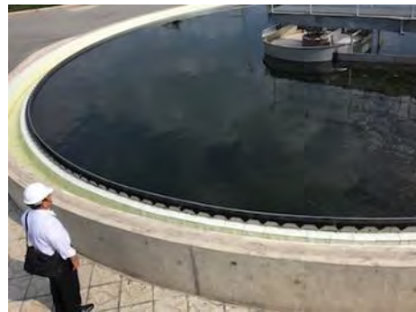
チャノック工業団地共同排水処理場の沈降槽
