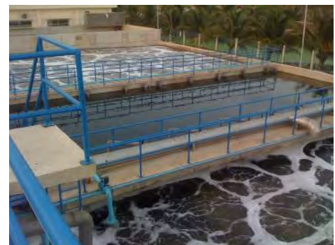
ホーチミン市の浄水場
