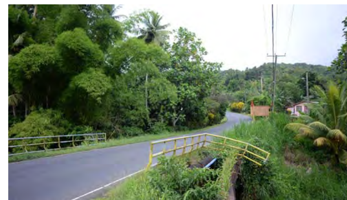
ラヴィン・ポアソン橋を撮影・鋼高欄が破損している
