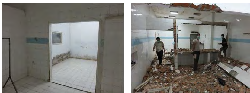
図5 ペリカナンマカッサル工場内の解体工事（左：解体前、右：解体作業）
