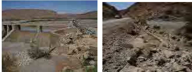
Barrage Kaddoussa et route bitumée dans la Commune de Ouad- Naam endommagée par les inondations en 2008
