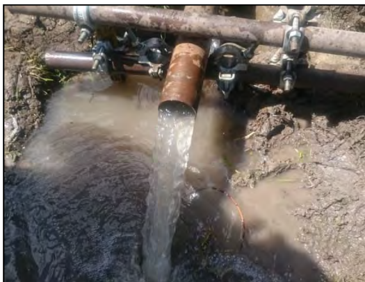
排水ボーリング孔からの湧水 ボーリング掘削直後の湧水状況（330 lit/min、2016年4月）
