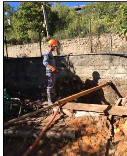
同左 孔口付近の状況
