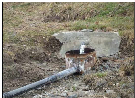
排水ボーリング孔の浸食防止仮設対策 孔口周辺にはコンクリートを打設して地下からの湧水による浸食を防止、下流にはパイプを設置して流水による地表浸食を防止（2016年9月、湧水は230 lit/minに減少）抜本対策は草の根支援で実施中
