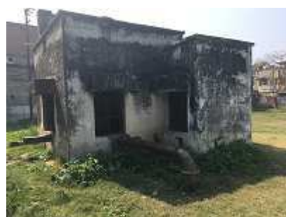
用地にあるポンプ施設（下水？）
