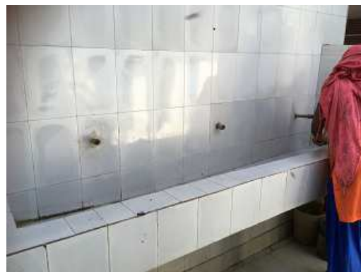
手洗い場（3 箇所中 2 箇所蛇口無し）
