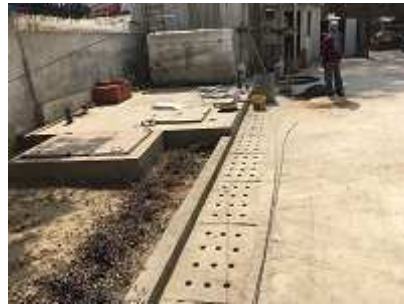
汚水処理施設
