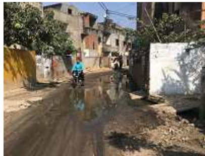
下水管路からの漏水
