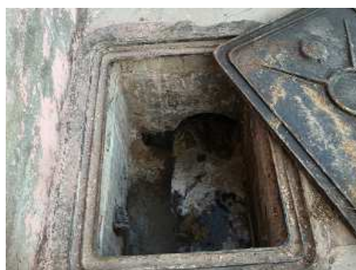
トイレ汚水が流れる側溝（蓋が開けられ不衛生）
