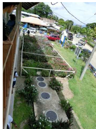
写真 3：学校に設置された TSS 全体の様子
