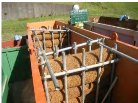
プラントの濁水処理
