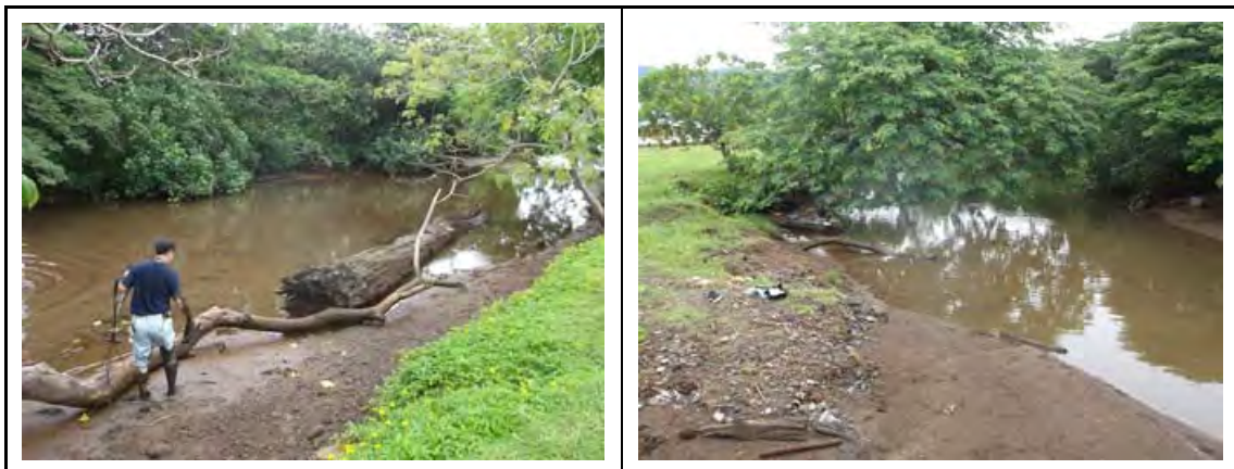
写真 3.83 「Fagalii tai outlet-5」の流木及び河岸侵食の状況
