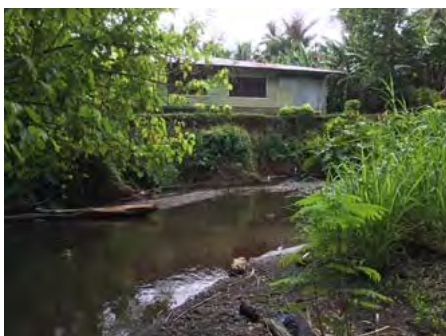
「Fagalii tai outlet-5」における河岸侵食により倒壊のおそれのある家屋
