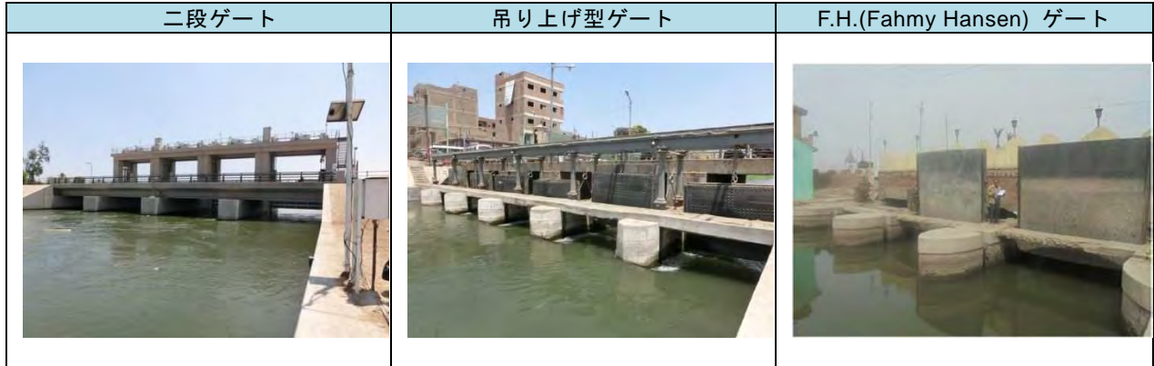
図 2-1.2 幹線水路沿いの調整堰のゲート形式
