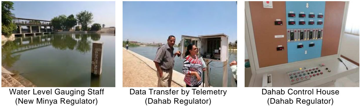
図 2-9.1 既設水位観測システム（左：水配分部、中央：テレメトリー部、右：IIS）
