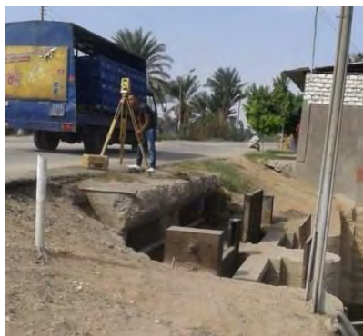
図 1-1.7 取水施設写真
