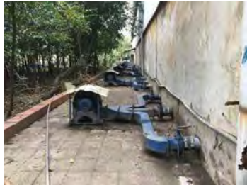
・一次発酵槽給気装置
