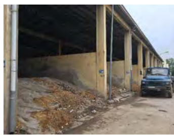
・一次発酵槽
