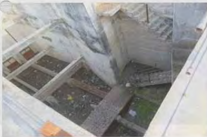
Note) 30-Sep-2015 Varanasi NagwaPS-3 Grit Chamber
