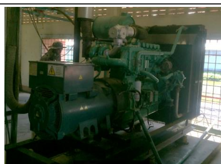
図 17 養豚場のガス発電機
