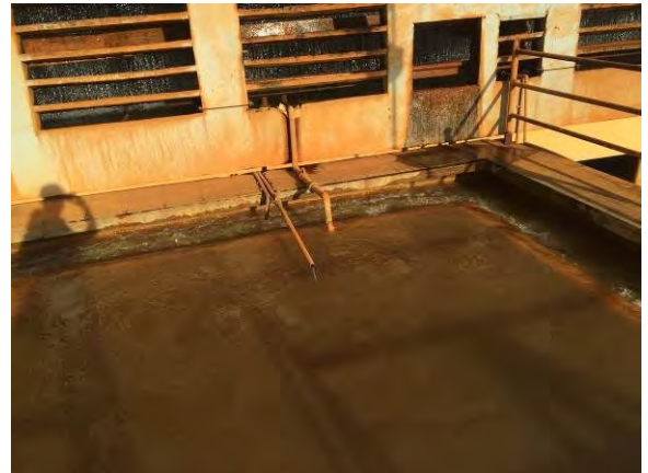
写真 薬品注入状況①
