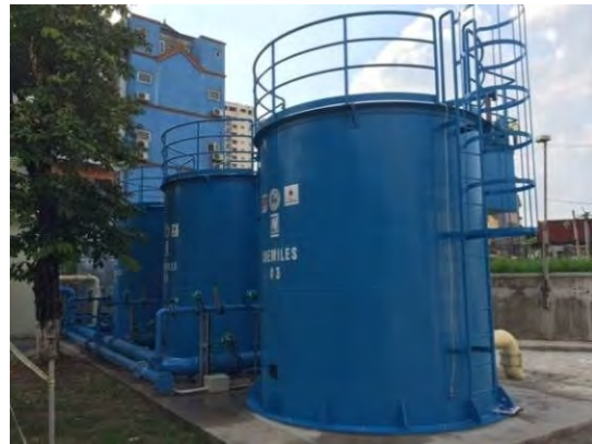
ケミレス設置状況（平成 28 年 6 月）
