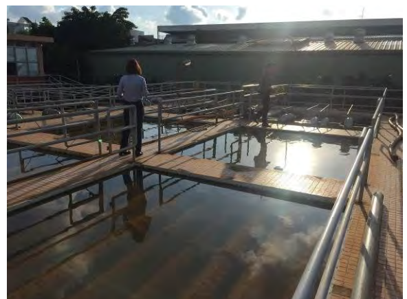
写真 凝集沈殿槽
