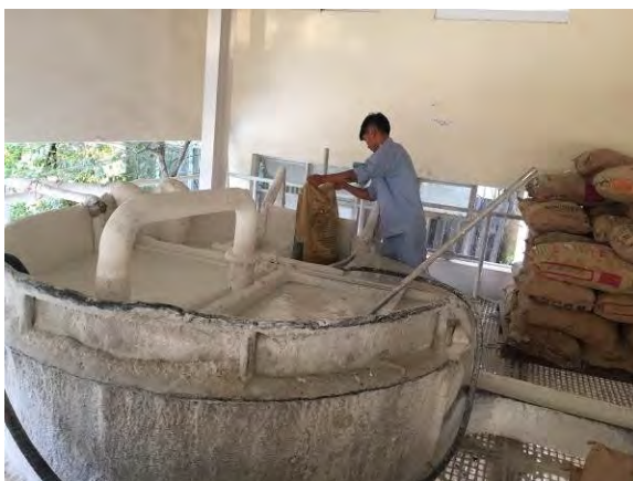
写真 薬品注入状況②
