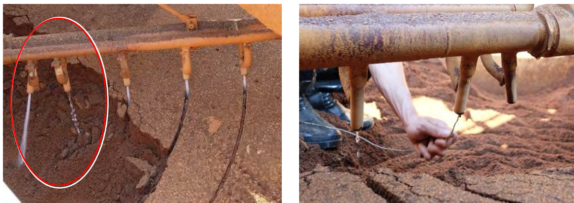
写真 表洗用ノズルの閉塞状況と清掃状況
