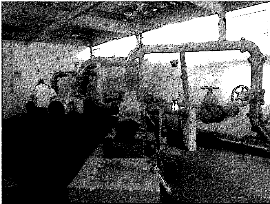
(sala de bombeamento de água)
