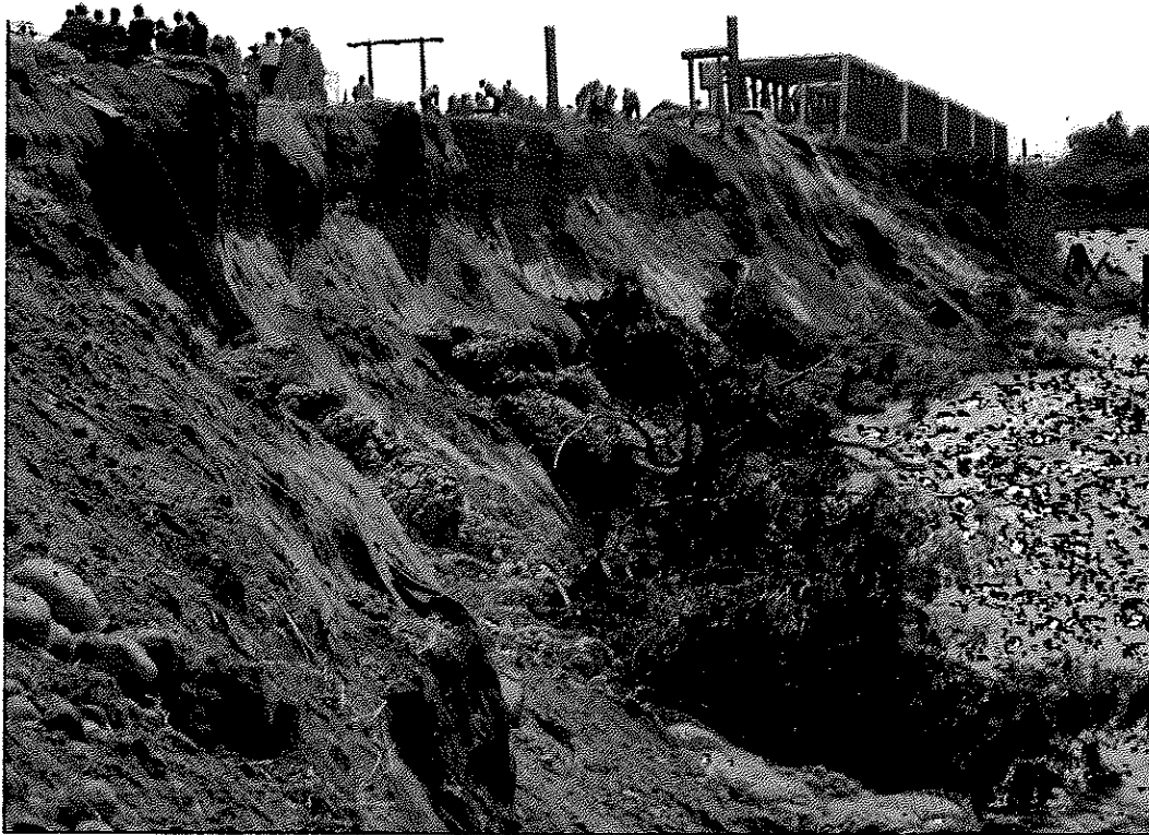
写真(2) 日ボ友好橋取付け道路盛土の崩壊(左岸上流)(2009年3月)
