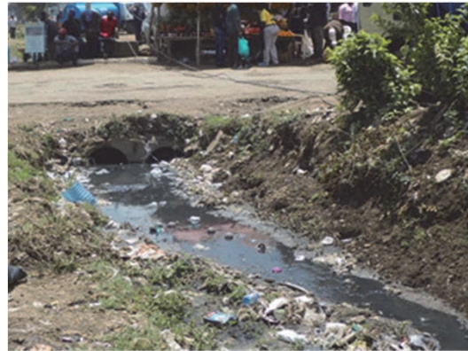
ダゴレッティコーナー交差点 排水溝が整備されておらず、ゴミが堆積し、汚水が滞水しており、不衛生な状態である。
