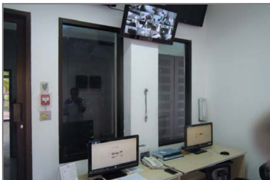
NIX Bari 監視室
