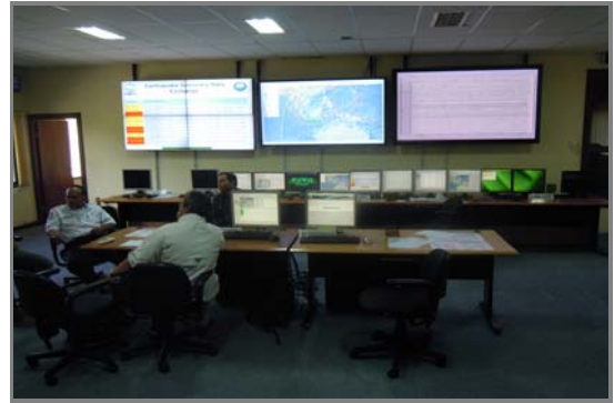
InaTEWS バリ コントロールルーム
