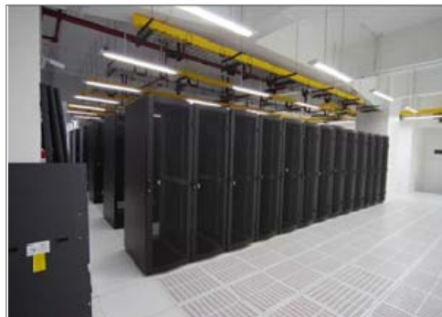
Cyber Building (ジャカルタ) データセンター内部
