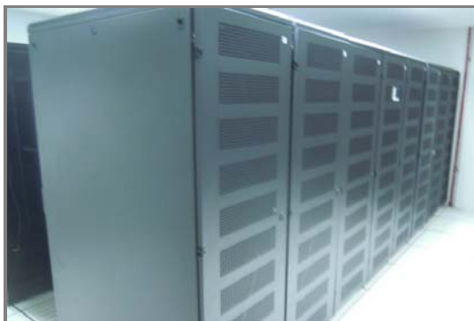
NIX Bari データセンター内部
