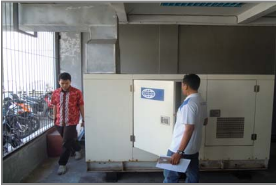
NIX バリ 非常用電源
