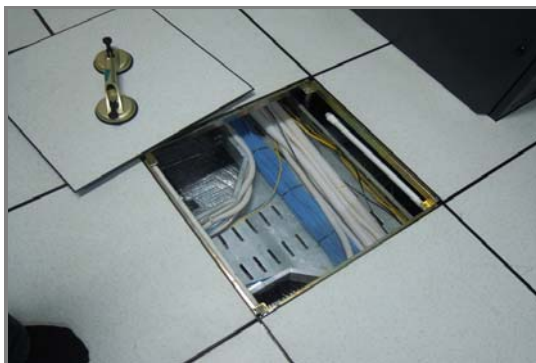
NIX Bari 床下の配線状況
