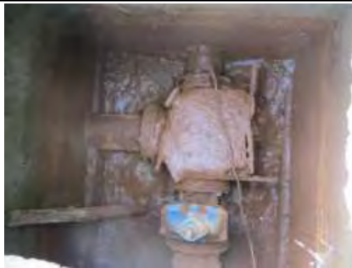
写真-5 配管 E 雨水の侵入によりバルブボックス内に泥が溜まっている。
