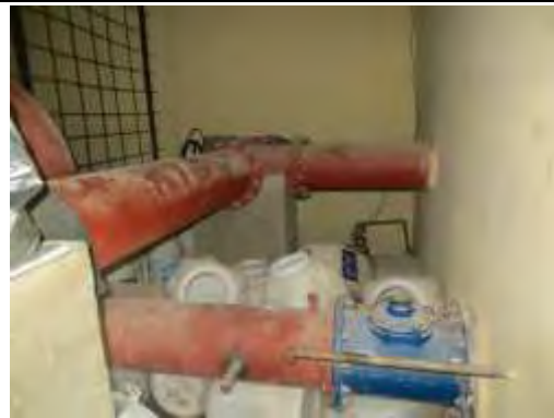
写真-6 配水場 A 塩素が適切に管理されておらず、容器が放置されている。
