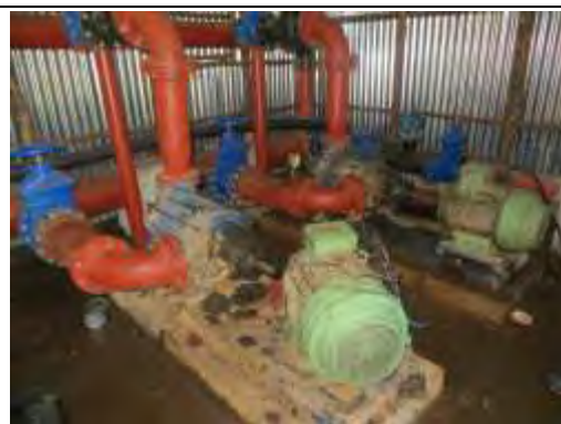
写真-8 送水場 A 壊れた送水ポンプが修理されずに放置されている。
