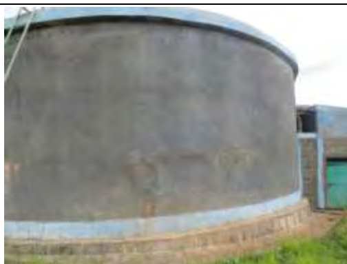
写真-7 配水場 B 配水池にエフロレッセンスが発生しており水密性が低下している。
