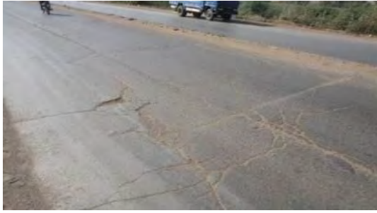
写真 舗装の破損状況：サグ部（ひび割れ）
