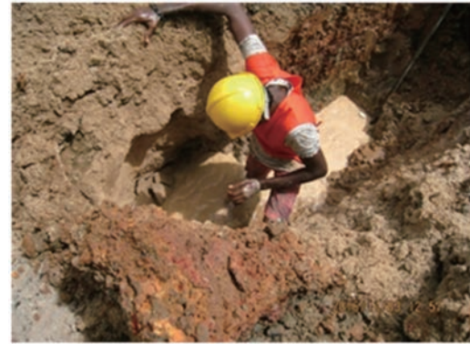
住宅地域での漏水 (南部州 RSC)
