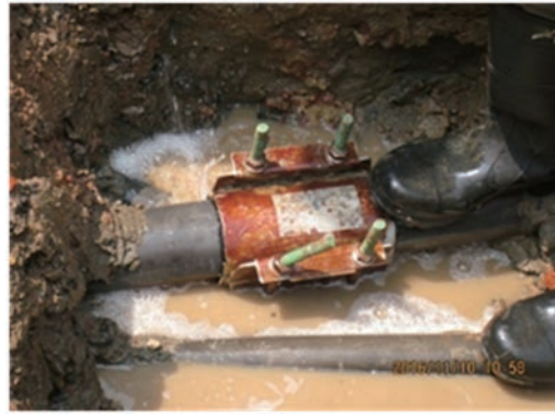
クランプで修理した箇所の脇で漏水 (Dehiwala 地区)
