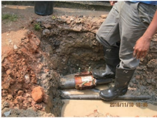
護岸工事に伴う重量車通過時に埋戻土中の石片が配水管を損傷して漏水 (Dehiwala 地区)
