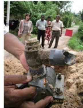
サドル分水栓の破損が漏水の原因 (南部州 RSC)
