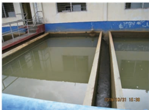
キャンディ市内浄水場のろ過池 (濁度除去が不十分)
