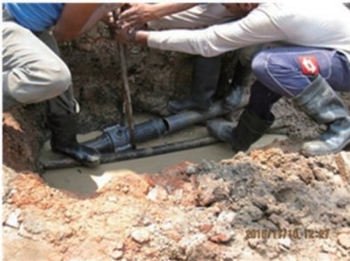
芯出し、面取りせずに、ゴムパッキン付継手で配水管切管部を接合（Dehiwala 地区）
