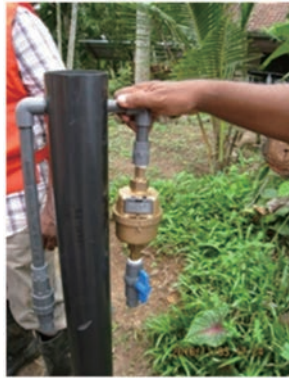
メーターを敷地内に設置 (南部州 RSC)
