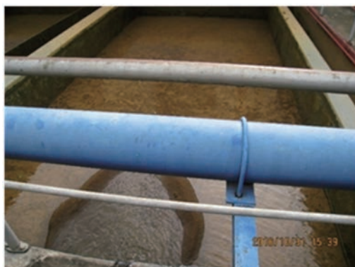
キャンディ市内浄水場のろ過池 (逆洗後も沈殿泥がろ層の表面に残り、沈殿 水流入部のろ層が洗堀されている)
