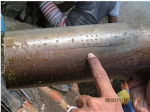
塩ビ管のクラック（断水後、鋸による管切断時に面取りしていない） (Dehiwala 地区)
