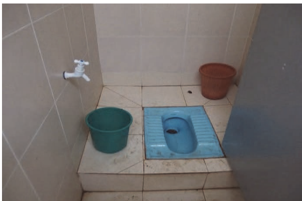
上記トイレ内観（水不足で水を汲みとれない）
