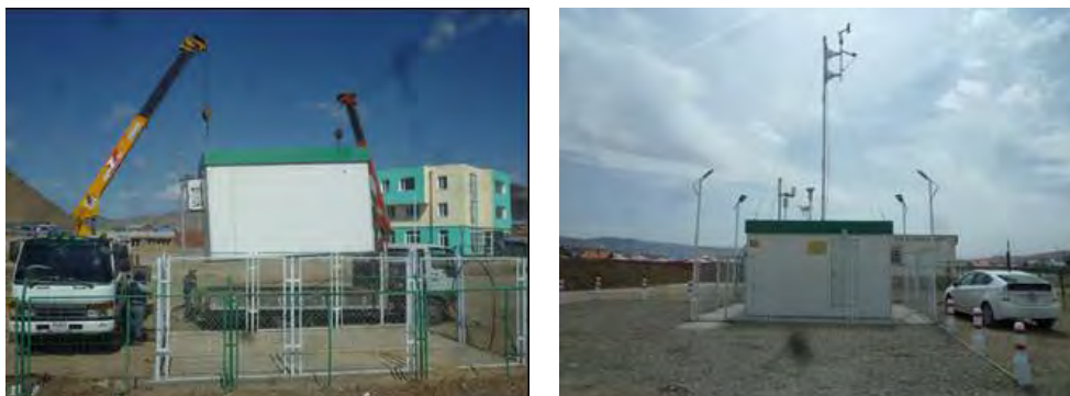
Зураг 2.1-3 Шинэ суурин харуул суурилуулалт
