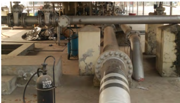
14 インチ (左)、8 インチ (右) ハイドラント配管 (払出配管)
