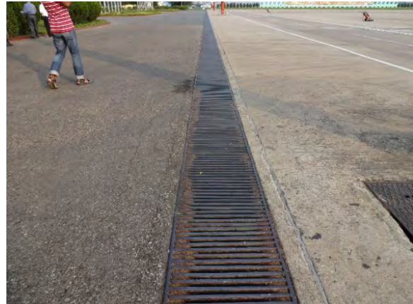
グレーチング付水路
