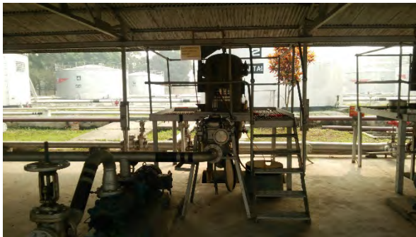
既存貯蔵タンク及びハイドラントポンプ、 フィルターセパレーター
